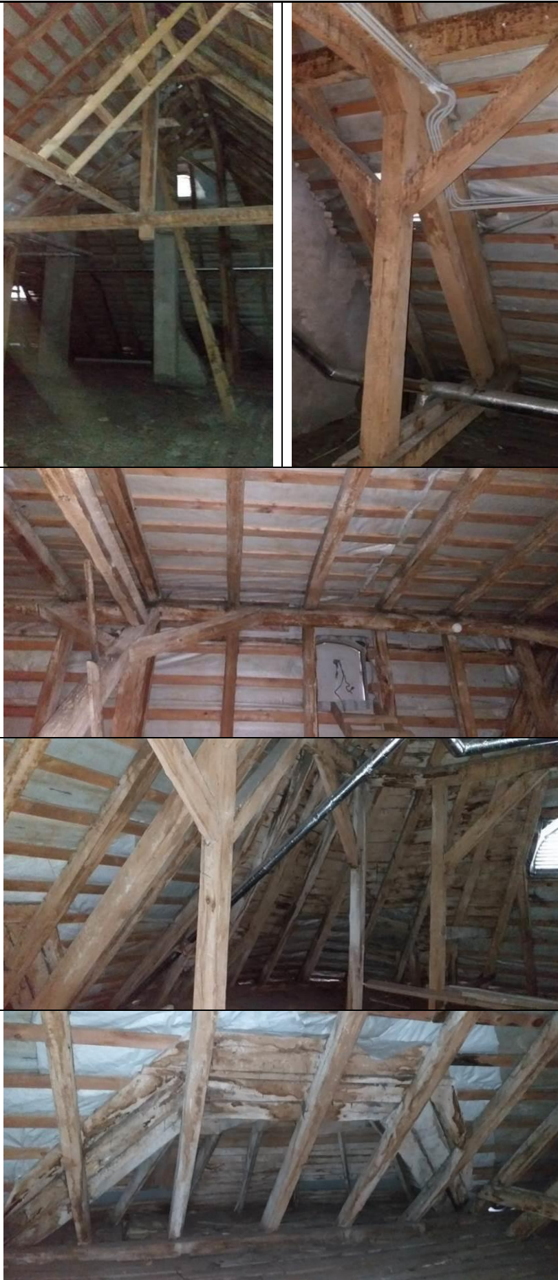
4.8.1.3.- 4.8.1.7.att. Jumta nesošās koka konstrukcijas, ar redzamiem mitruma bojājumiem
