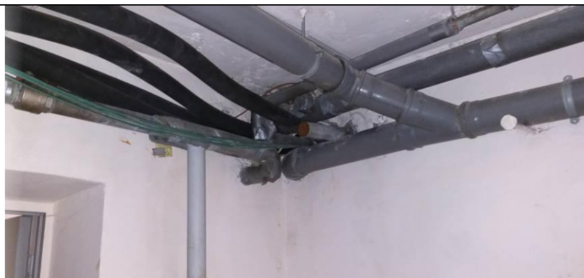
5.1.2.1., 5.1.2.2. att. Sadzīves kanalizācijas iekšējais tīkls, PVC caurules
