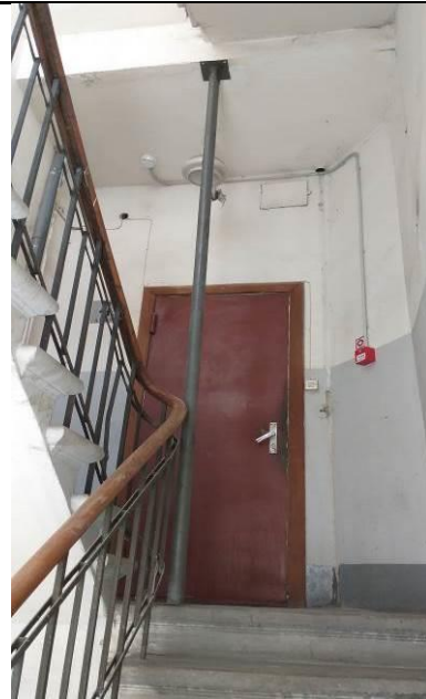
4.10.1.9.att. Kāpņu laukuma pastiprinājums 4.stāvā, kāpnēs Nr.6
