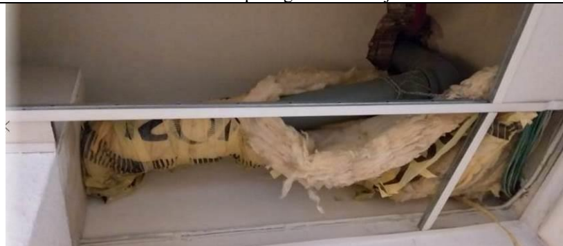
4.6.2.4. Pārsegumā ierīkoti atvērumi, sanitārtehniskajā telpā
