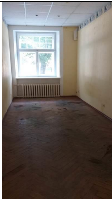
4.12.1.5.att. Nolietojusies parketa grīda ēkas 1.stāvā, biroja telpās
