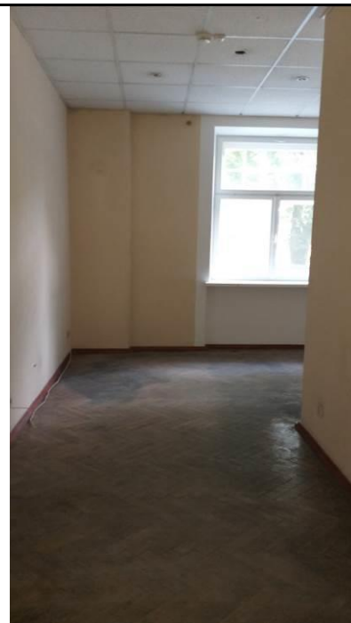
4.12.1.6.att.Nolietojusies parketa grīda ēkas 1.stāvā, biroja telpās
