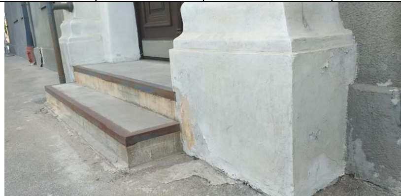
4.10.1.16.att. Ārējās kāpnes ar korodējošiem metāla lenķiem, no Eksporta ielas
