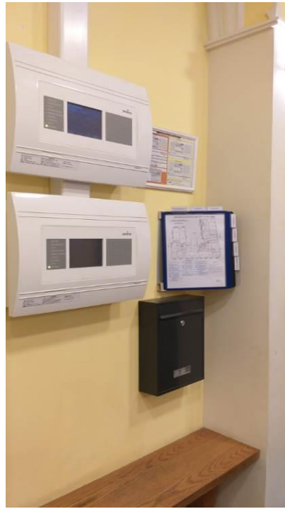
5.3.2.5.att. Signalizācijas pulsts Kāpnēs Nr.4
