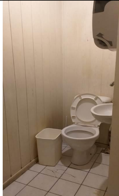
4.12.1.3.att. Bojāta flīžu grīda 1.stāva sanitārtehniskajā telpā
