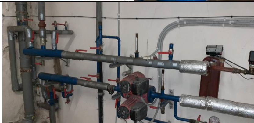
5.2.1.2.-5.2.1.4.att. Siltummezgla iekārtas un aprīkojums
