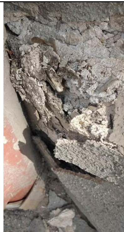
4.1.2.2. att. Uz ārsienām vērojama sēnes attīstības aktīvi procesi
