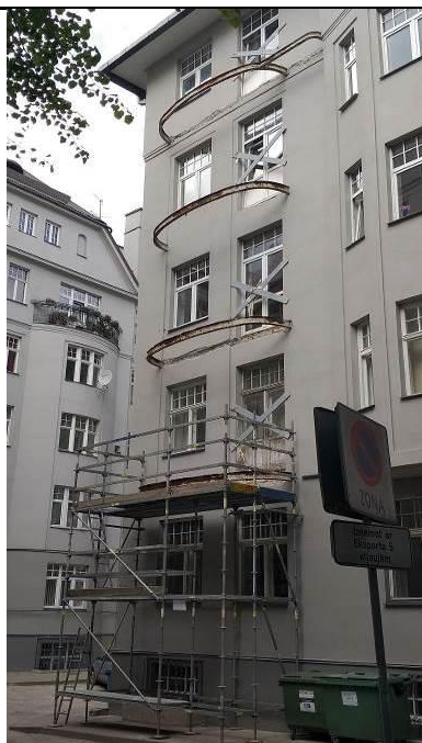
4.9.1.3.att. Skats uz izjauktiem balkoniem
